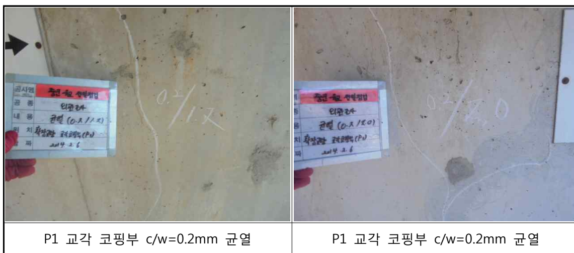
【표 4.14】 중군육교(램프) 교각 손상물량
