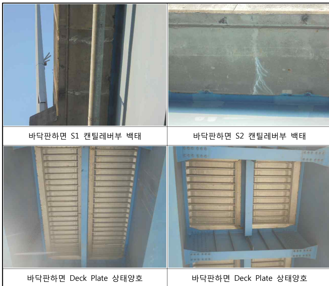
【표 4.8】 중군육교(램프) 바닥판하면 손상물량
